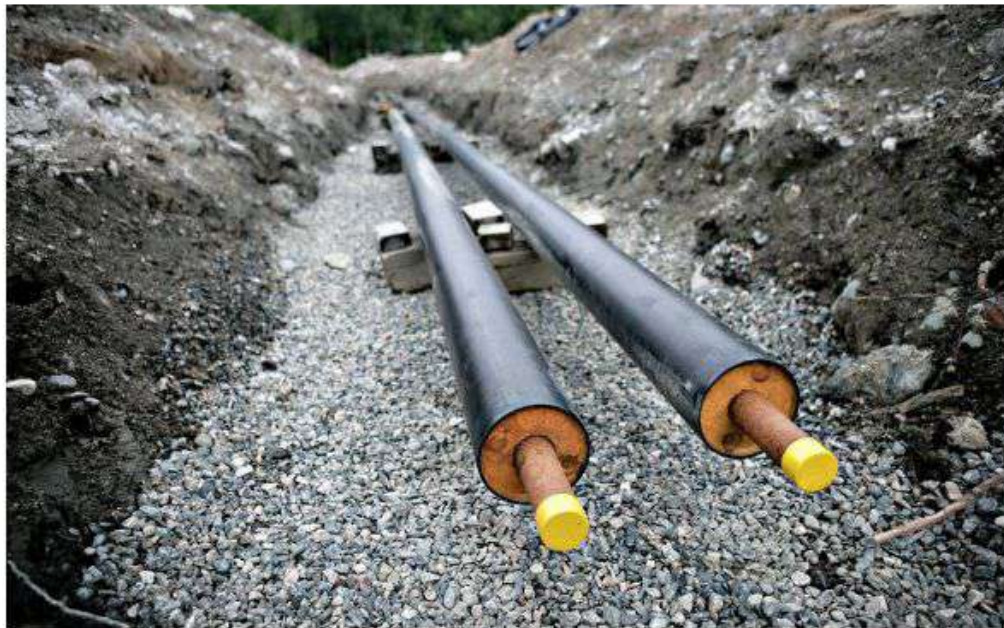
Lämpöakun putket. Kerrostaloa voidaan käyttää lyhytaikaisena lämpöakuna, jos huoneiston sisäiset olosuhteet ovat selvillä.
